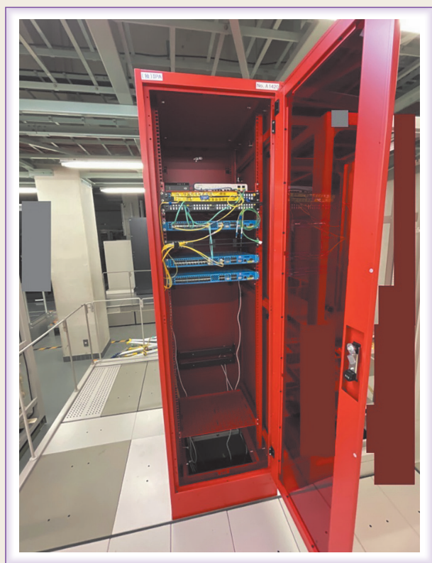
図7 行政主体の中において、職員たちで電話局の中に自前の通信ラックを立ち上げ、ダークファイバ等を借り受けて通信キャリアと対等にネットワークを内製化する動きがある。（写真はIPAの内製通信架）
