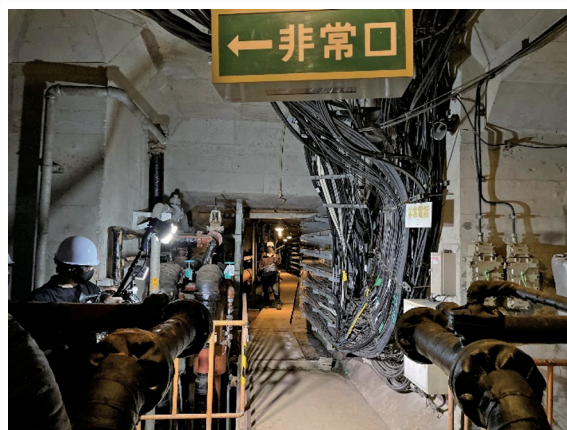
図4 筑波大学の地下にある光ファイバや電力水道を通す等のための全長14 kmもの巨大な地下通路
