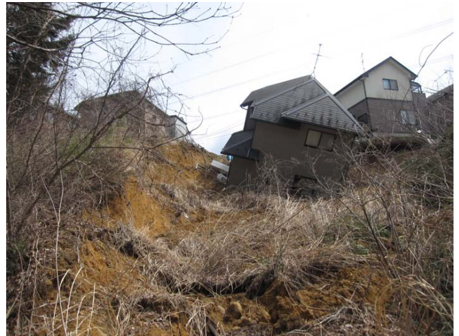
写真 1 宅地の滑動崩落の一例（東日本大震災）。
