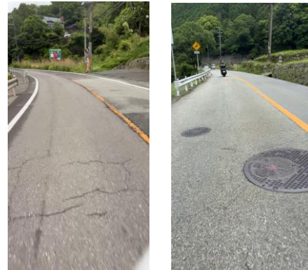
(d) 線状ひび割れ (横方向)
