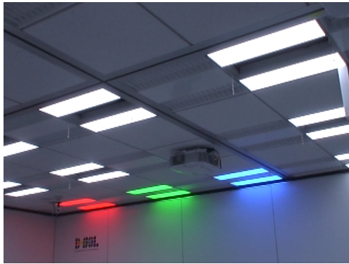
図3 初期状態のLED照明
