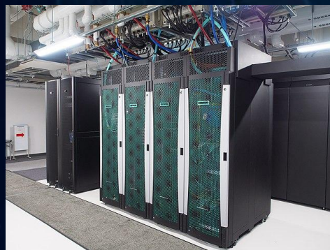
東工大スパコン TUBAME 水冷システム
