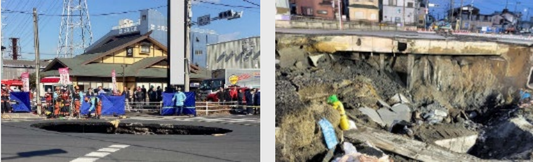
八潮の道路陥没
