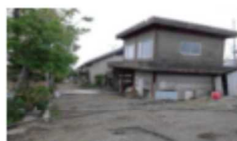
液状化で被災した住宅
