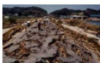
液状化で被災した堤防
