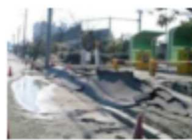
液状化で被災した道路
