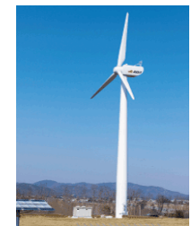
風力発電設備
