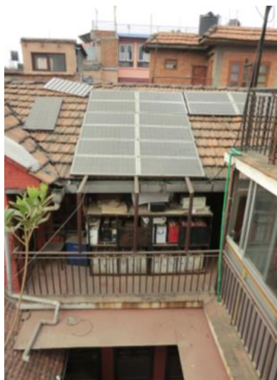
ソーラーが設置
