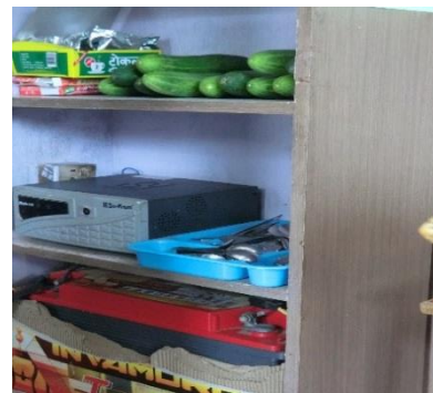
パン屋のインバータと蓄電池
