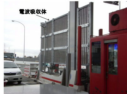
ETC 料金所へ施工した電波吸収体の例
