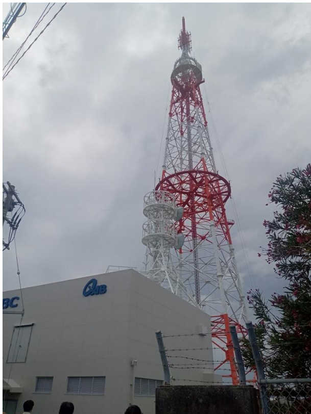
アンテナ鉄塔, 局舎
