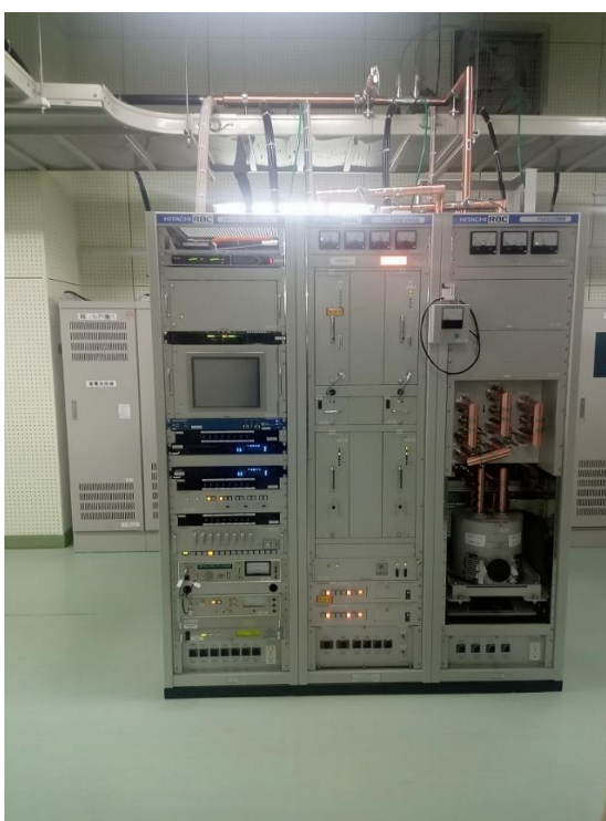
FM 送信設備(局舎内)
