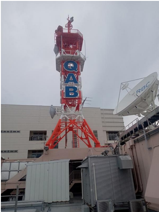
RBC 琉球放送本社の屋上の STL 送信鉄塔
