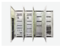
計装制御システム
