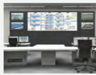
上下水道プラントシステム
