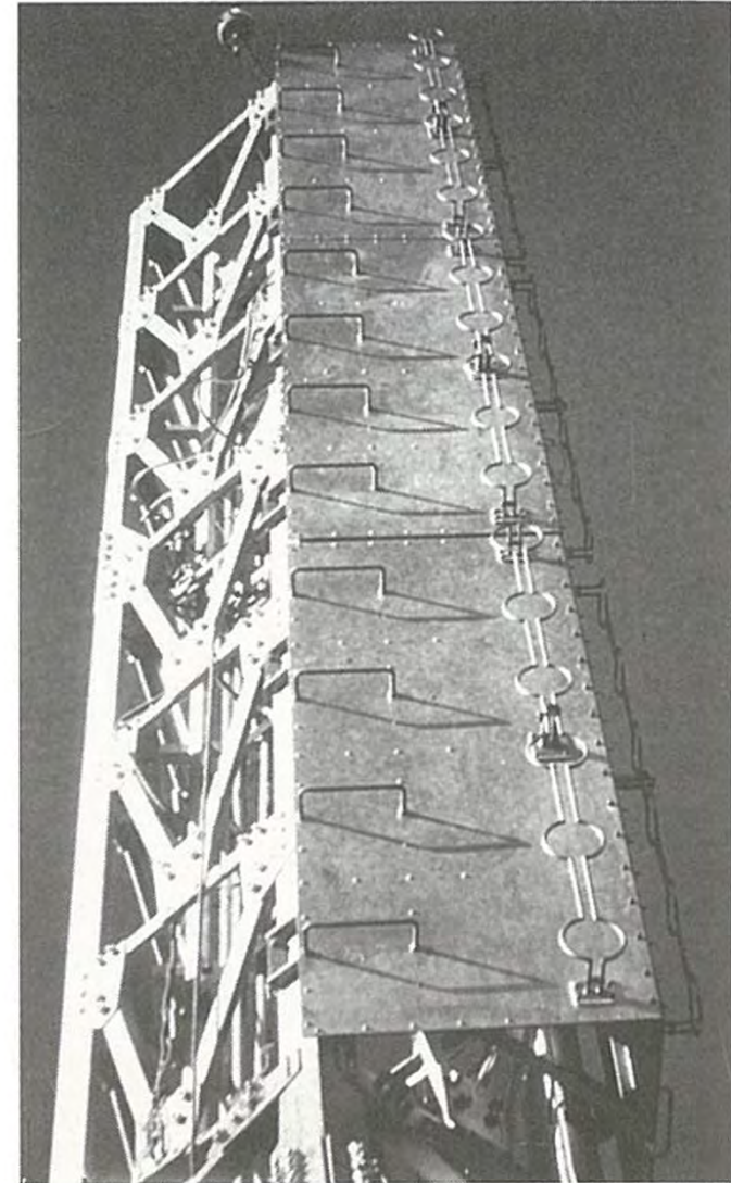
〈写真12〉NHK十王テレビ中継局の双ループ・アンテナ(6L3段2面；初めて双ループ・アンテナを実用したテレビ中継局)
