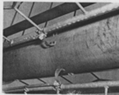
スーパーターンバットウイング給電部
